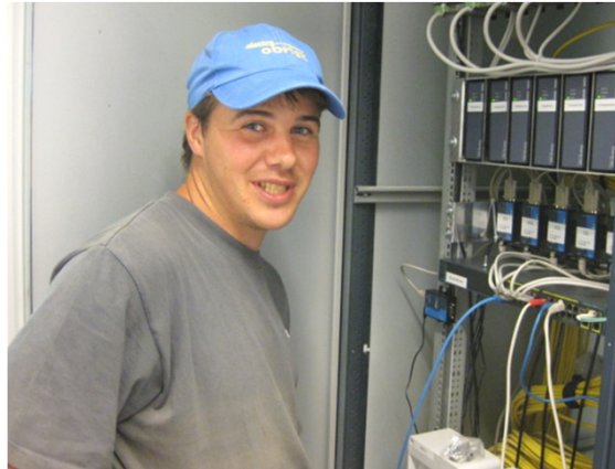
Vitus Obexer, Firma Obrist, im Rechenzentrum
